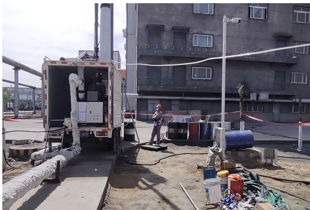
真空抽提装置运行中
